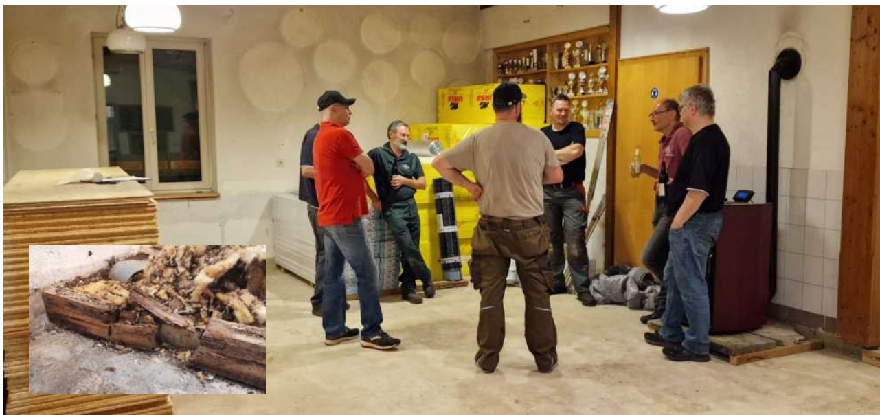
Die fleißigen „Arbeitsdienstler“ im Aufenthaltsraum bei der Renovierung der Bodenfläche Detailbild Schäden durch Feuchtigkeit am Boden.
